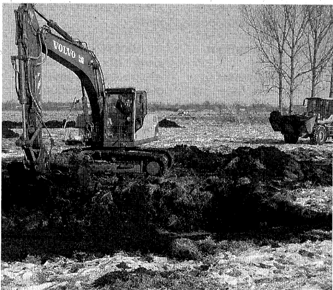
Dank des gefrorenen Bodens konnte der Bagger auf dem Acker in Nauen sofort loslegen. FOTO: WEGENER
