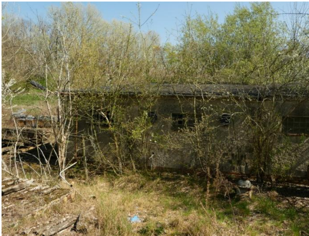
Abb. 1: Blick auf das verfallende Gebäude
