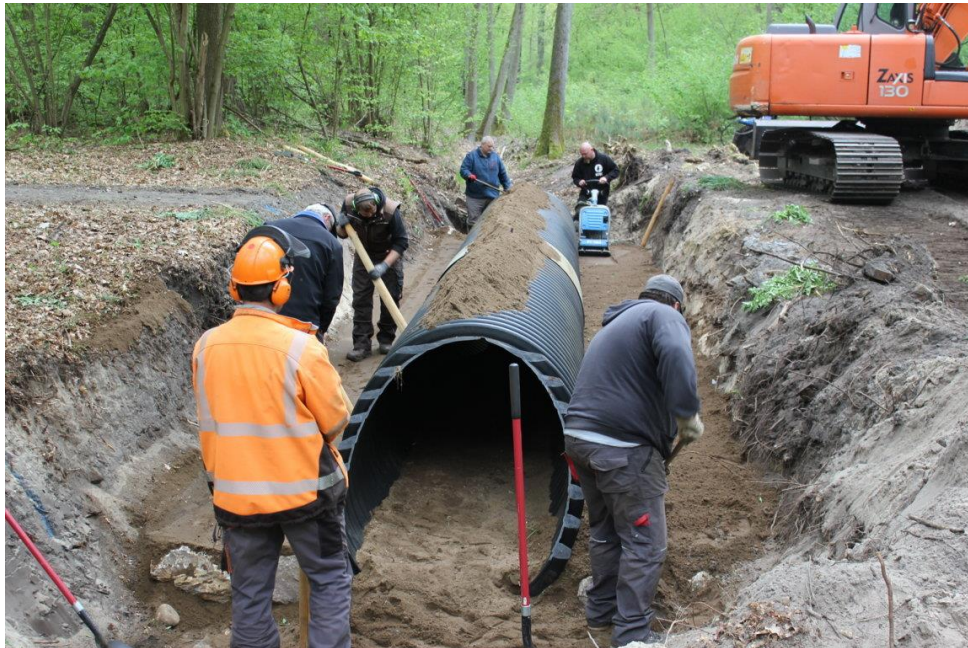
Abb. 3: Einbau eines lichten Rohres als Durchlass an einer der zu erneuernden Überfahrten im Mai 2020
