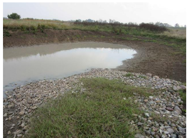
und im Qualmwasserbereich Lütkenwisch aus Januar 2016
